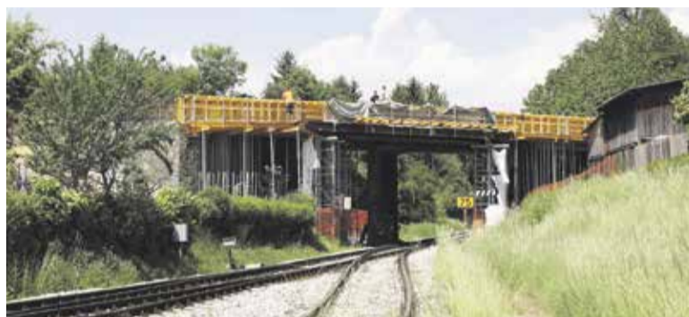
Po izgradnji brvi nad regionalno Kamniško cesto se izvaja še en premostitveni objekt nad železniško progo.
