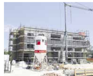
Na Domu krajanov v Študi je zgrajena streha, izvaja se fasada in brusijo betoni.
