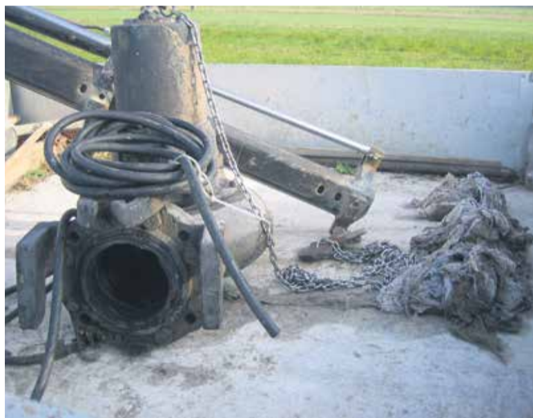
Eno izmed večjih težav v kanalizaciji predstavljajo vlažilni robčki in druge krpice, ki povzročajo zamašitev cevodvodov in okvaro črpalke.
