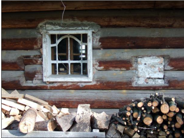
Slika 21: V 20. letih 20. stol. vzidana okna z železnimi mrežami, prvotna okna »na smuč« so zabita ali zazidana. Foto: Saša Roškar, arhiv ZVKDS OE Kranj.
