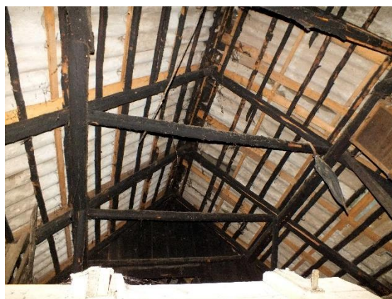
Slika 18: Tramovi na ostrešju so črni od dima, ki se je nekoč valil na podstrešje.
