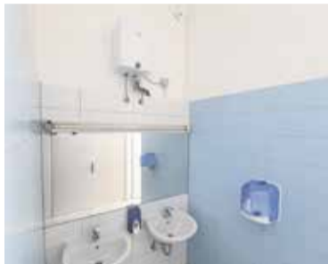
Novi grelniki vode v vseh straniščih na OŠ Domžale
